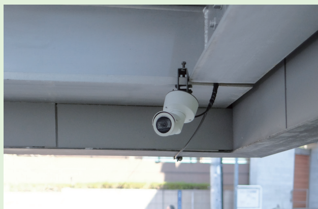
防犯のためにはより目立つようにカメラを設置することがポイント
