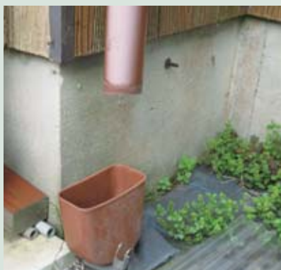
▲雨どいの破損
