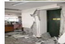
(※)東日本大震災後のA市役所の損傷状況
